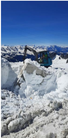
Bildlegende: Schneeräumung Podest Stütze 2
