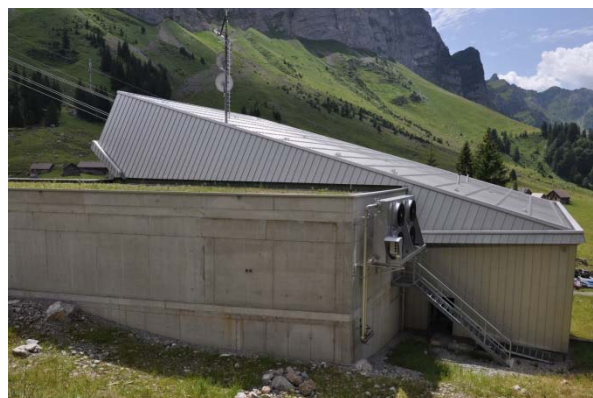
An der Rückseite der Talstation wurden die Aggregate für die Rückkühlung der Erdsondenheizung platziert.
